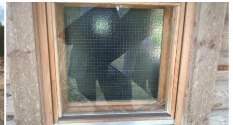
Hiihtomajalla tehtiin toukokuussa ilkivaltaa rikkomalla ikkunoita, polttamalla rakenteilla olevan grillikatoksen rakennusmateriaaleja, purkamalla kodan grilli piippuineen ulos sekä sotkemalla paikkoja.
